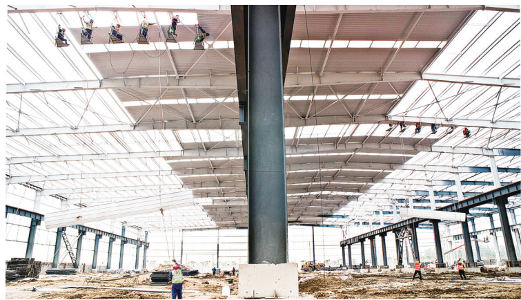
新园区项目施工现场昼夜奋战,一派热火朝天的忙碌景象。当前一标段钢结构主体完工,二标段钢结构安装钢柱已超过60根,三标段基坑开挖完成30000立方,四标段油膜厂房桩基工程已经完工。图中的施工人员正在为一标段焊接中心一号厂房安装厂房屋面内板。 (文/赵志磊 图/赵大江)
